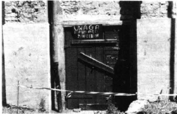
Na zabitych deskach drzwi wisi napis: „Uwaga budynek grozi zawaleniem”
