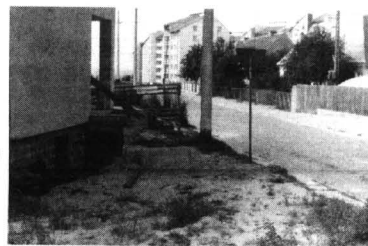
Ciągle nie zabezpieczona budowa przy ul. Krańcowej
