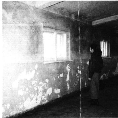
Popularne skutki niewłaściwego zabezpieczenia przed wilgocią (tu budynek dworca PKP w Tczewie)
