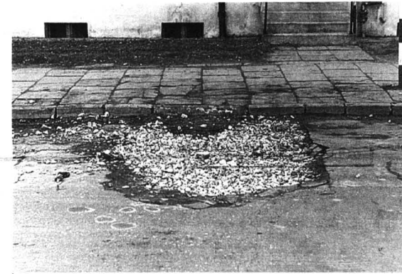
Raport zwraca uwagę zwłaszcza na zły stan dróg wojewódzkich. Takie dziury na kwidzyńskich ulicach już nikogo nie dziwią
