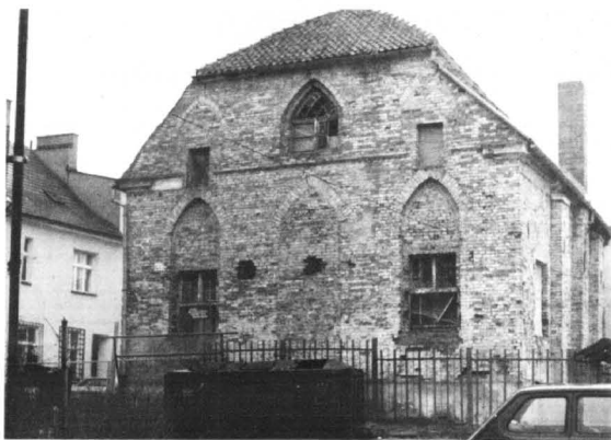
Samorząd chce przeznaczyć na zabezpieczenie mocno zniszczonego zabytku 30 tys. zł.
