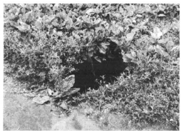
Nietrudno wpaść do nie zabezpieczonej studzienki
