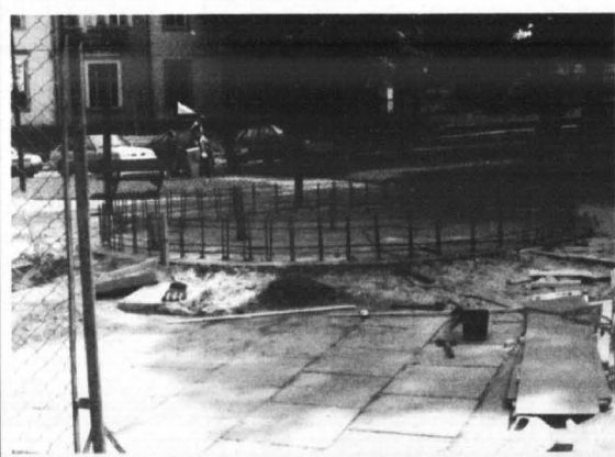
Przed Urzędem Gminy w Kwidzynie ruszyła budowa fontanny, która już wkrótce da ukojenie w upalne dni mieszkańcom miasta
