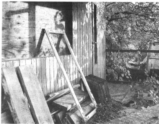
Zniszczonych altanek czasem nie chce się już naprawiać
