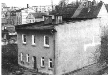
Sporny dach i niesprawna antena
