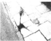
Dziura w chodniku przy ulicy Willowej 29
