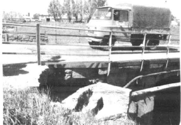
Dziura przy wiadukcie
