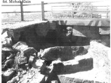
Mieszkańcy pobliskich ulic bali się, że osypujący się beton stanowi zagrożenie dla ruchu
