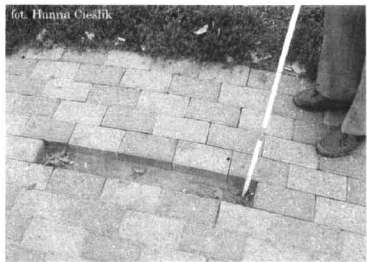
Te ubytki powinny zostać niezwłocznie uzupełnione
