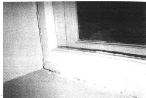
Obok okna wystąpiły znaczne pęknięcia
