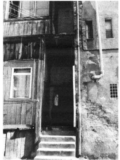
Czekamy na remont - mówią mieszkańcy
