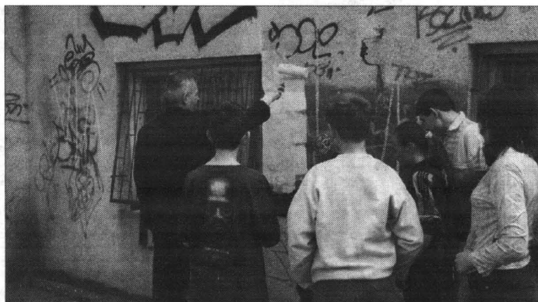
W malowaniu elewacji budynków szkolnych uczniom pomagał Krzysztof Święcicki, komendant elbląskiej policji
