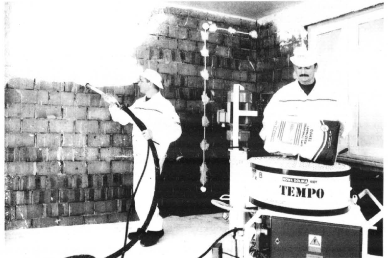
Tynki gipsowe najlepiej narzucać na ścianę za pomocą pistoletu natryskowego, połączonego ze specjalnym agregatem
