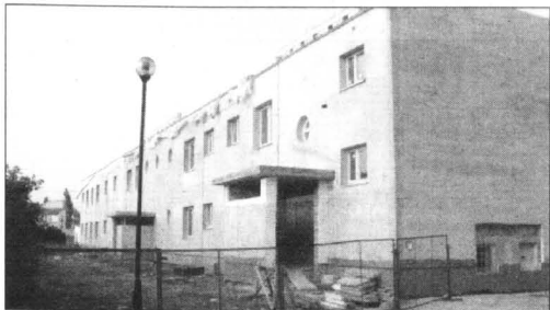
Ulica Polna. W lipcu zakończy się modernizacja budynku po „Budowlance”. Będą tam 24 lokale. Koszt inwestycji - 1,3 mln zł. Fot. Mirosław Wiśniewski
