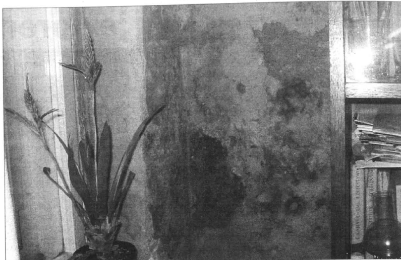
Część ściany w pokoju gościnnym Waldemara K. zajmuje...grzyb. Nie wiadomo kto pokryje koszty remontu: właściciel czy zakład komunalny.
