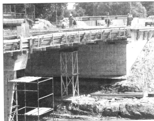
Budowa małej obwodnicy to jedna najważniejszych kwidzyńskich inwestycji. Na tę inwestycję przyznano dofinansowanie z Unii. Budowa trwa.
