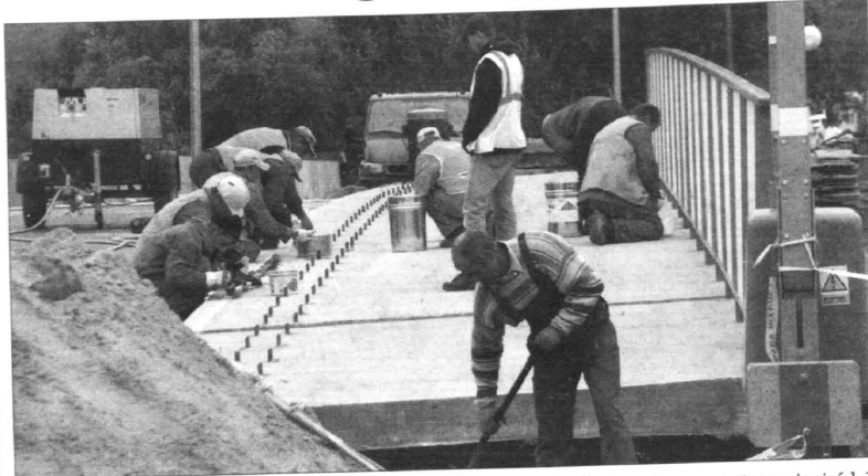
Wiadukt łączący ulicę Żwirową z Południową jest już gotowy. Jednak nie można na razie po nim jeździć - potrzebna jest zgoda z Urzędem Wojewódzkiego w Gdańsku, która spodziewana jest w listopadzie. Fot. Mirosław Wiśniewski
