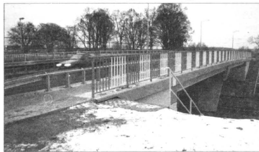
Dzisiaj uroczyste otwarcie wiaduktu łączącego ul. Żwirową i Południową w Kwidzynie. Kierowcy jeżdżą tamtędy już od kilku tygodni, mimo że dopiero od kilku dni jest na to oficjalne pozwolenie.
