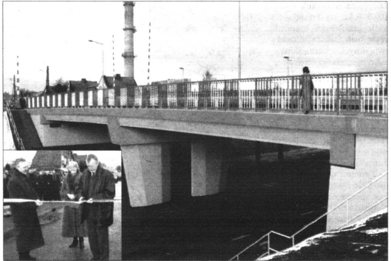
Nowy wiadukt wraz z drogami dojazdowymi jest pierwszym odcinkiem małej obwodnicy dla Kwidzyna.
