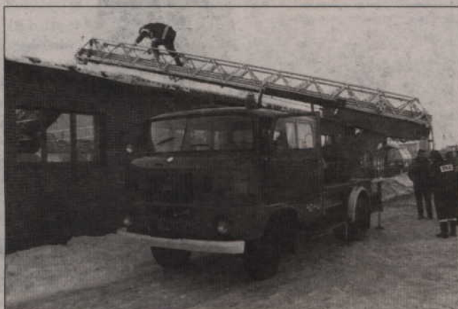
Inspektorzy kwidzyńskiego nadzoru budowlanego pod raz drugi w tym roku sprawdzali, czy na dachach dużych obiektów zalega śnieg. Najwięcej zastrzeżeń było do sklepów sieci Biedronka.
