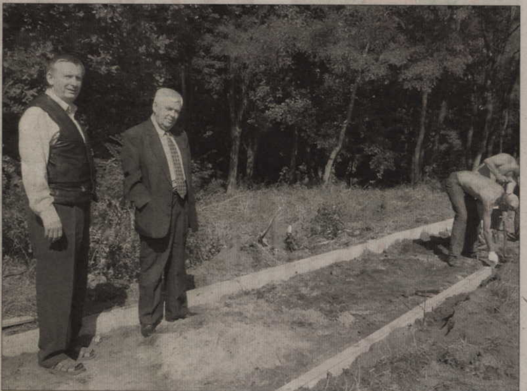
Postępami prac w Górkach interesowali się Edmund Wierzba, wójt gmin Kwidzyn (z prawej), oraz Bogdan Muchowski, radny Kwidzyn. Na zdjęciu: chodnik w trakcie budowy, który będzie prowadził przez park. Fot. Jacek Kluczkowski
