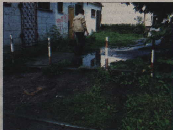
Tutaj źle rozwiązano sprawę odpływu wody. W dni deszczowe robi się wielka kałuża z wody spływającej z trzech sąsiadujących ze sobą działek – mówi pan Bernard T. mieszkający przy ul. 15 Sierpnia w Kwidzynie.
