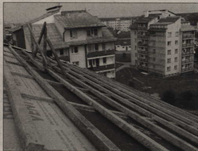
Eternit to najbardziej rozpowszechniony materiał budowlany zawierający niebezpieczny azbest. Może jednak szkodzić tylko wówczas, gdy jest zniszczony i zaczyna pylić.
