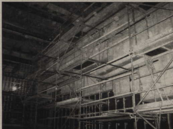
Trwa remont kwidzyńskiego kinoteatru. Robotnicy zdemontowali m.in.: światła, sprzęt kinowy, krzeselka. Obecnie wykonują prace murarskie wewnątrz obiektu. Fot. Mirosław Wiśniewski
