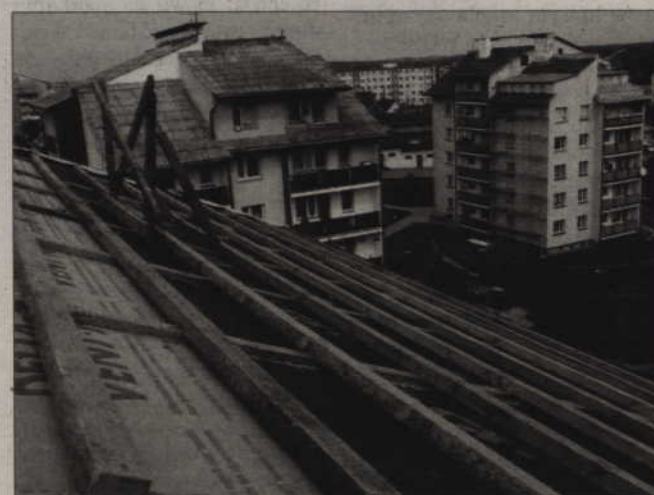
Aby usprawnić usuwanie szkodliwego azbestu z dachów, trzeba zmienić powiatowy fundusz, dotujący takie inwestycje. Chodzi o to, aby umożliwić korzystanie z niego mieszkańcom wszystkich gmin.
