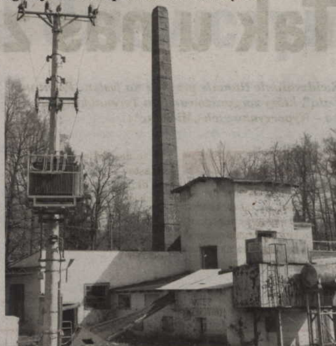
Budynek gorzelni jest w fatalnym stanie. Od lat nieużytkowany, często staje się miejscem amatorów tanich trunków. Fot. Mirosław Wiśniewski
