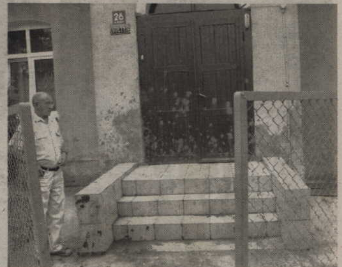
W czasie deszczu budynki ochlapywane są błotem. Nie ma szans na zrobienie nowej elewacji. Czyszczenie ścian to syzyfowa praca. Także budynek sąsiadów jest ciągle w błocie - twierdzi Michał Michaliszyn, sołtys Marezys.
