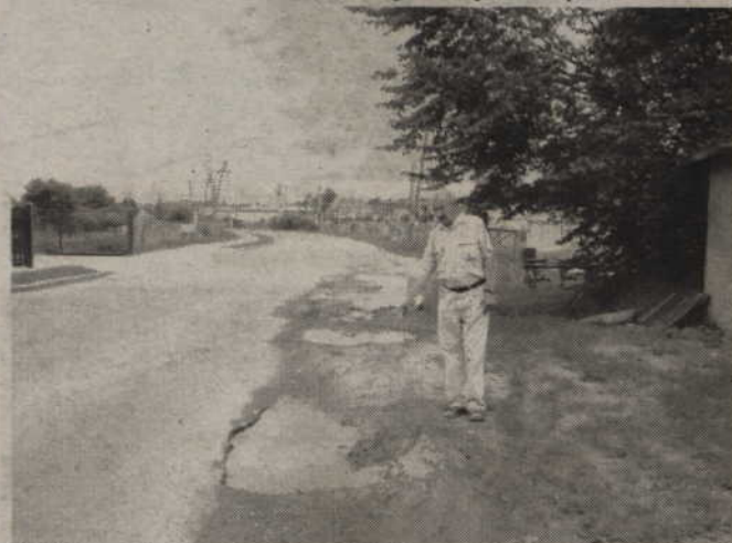
W ubiegłym roku, w czasie remontu wiaduktu na drodze krajowej z Kwidzyna do Grudziądza, droga była wykorzystywana przez ciężkie pojazdy jako objazd. Ciężarówki zniszczyły nawierzchnię i pobocza. Zdjęcia: Jacek Kluczkowski
