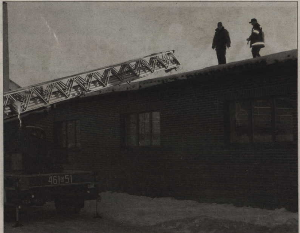
Szczególnej kontroli podlegają płaskie dachy sklepach o dużej powierzchni. Zalegających na nich śnieg może spowodować katastrofę budowlaną. Na zdjęciu: ubiegłoroczne sprawdzanie dachu na sklepie Biedronka.
