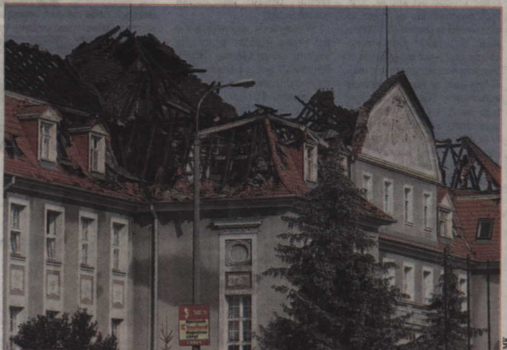
Tak wyglądał budynek Urzędu Miejskiego nazajutrz. Gdy ugaszonoogień, gmachem zajęli się pracownicy nadzoru budowlanego.
