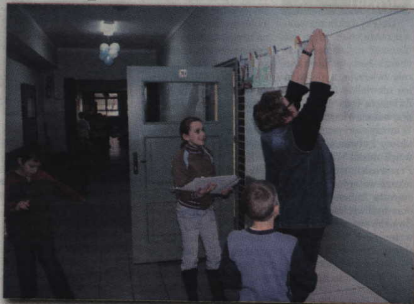
Remont w Szkole Podstawowej nr 4 - to przede wszystkim osuszanie zawilgoconych ścian w części budynku.
