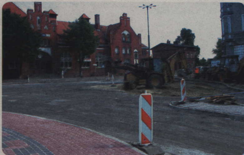
Trwa budowa kolejnego ronda, które ma poprawić komunikację w mieście. Powstaje ono na skrzyżowaniu ulic Chopina i Kościuszki, przy dworcu PKP.
