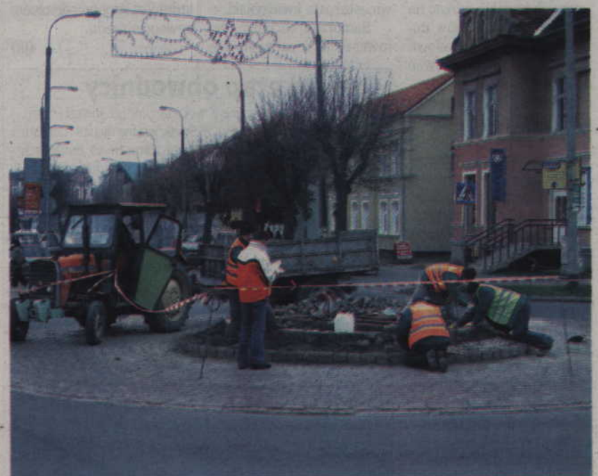
Wielki metalowy rower lada chwila ozdobi rondo na skrzyżowaniu ulic Chopina i Kopernika. We wtorek trwały jeszcze prace przygotowawcze. Fot. Mirosław Wiśniewski
