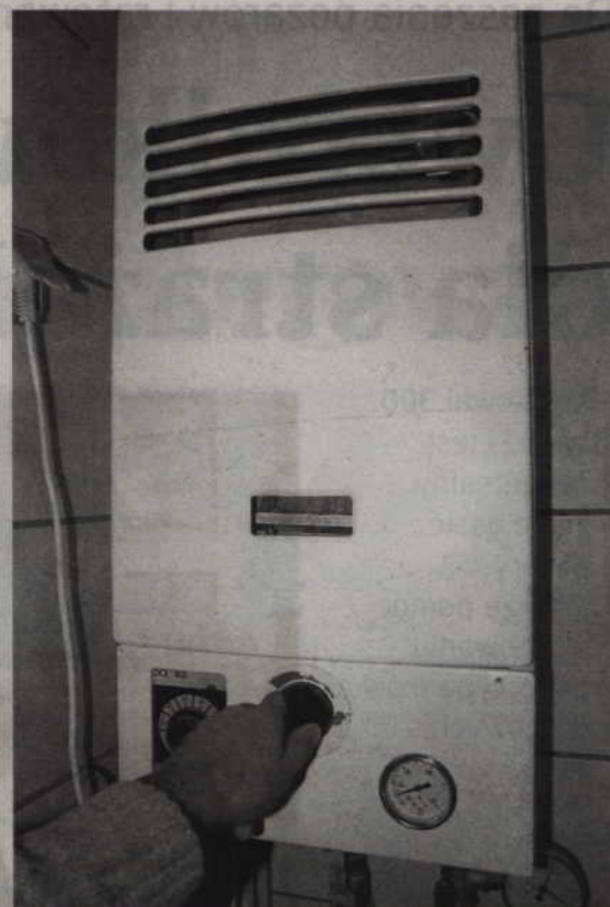
Każdego roku z powodu zatrucia tlenkiem węgla ginie kilkadziesiąt osób. Przyczyną może być wadliwe funkcjonowanie piecyka gazowego lub braku odpowiedniej wentylacji, szczególnie w niewielkich pomieszczeniach.
