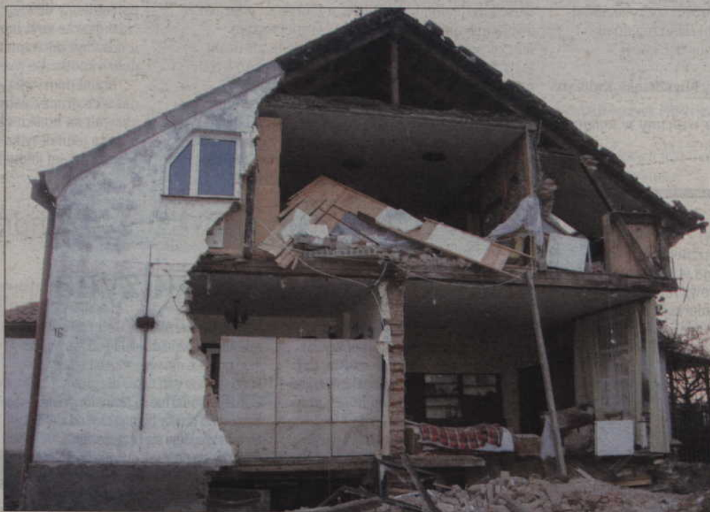
Inspektorzy nadzoru budowlanego badają, dlaczego zawaliła się ściana domu mieszkalnego przy ul. Żwirowej.
