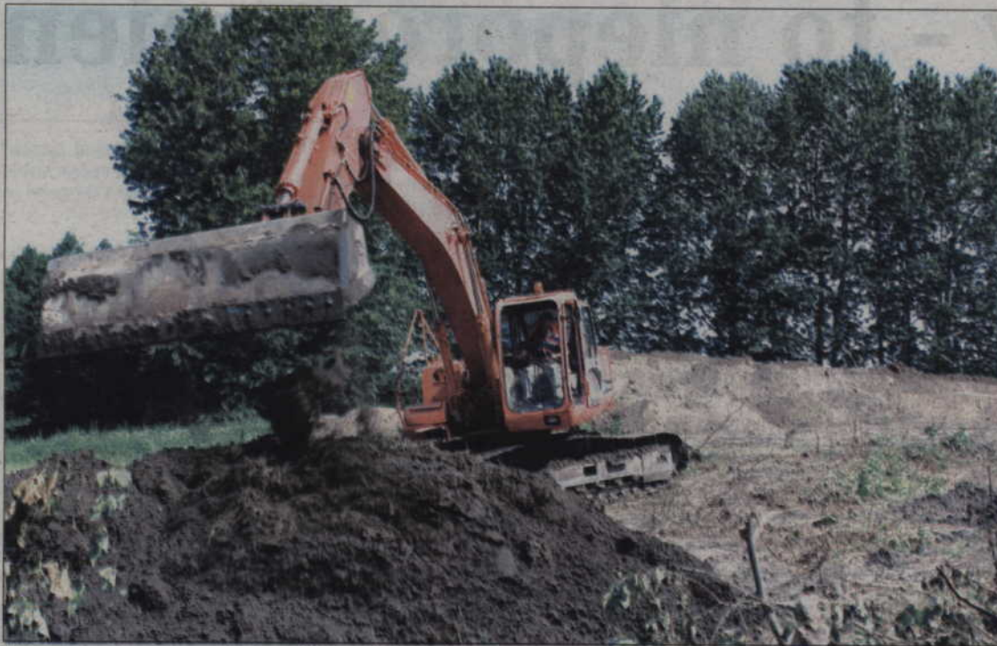
Wykonawca nie wyklucza oddania małej obwodnicy do użytku przed terminem. Na całej długości przyszłej małej obwodnicy dla Kwidzyna trwają prace. Zgodnie z umową prace mają zakończyć się w listopadzie.
