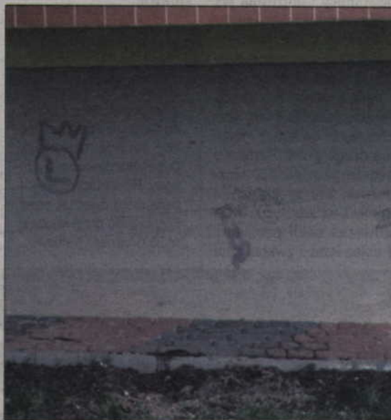
Także w Kwidzynie wandale często niszczą elewacje budynków umieszczając na nich napisy.
