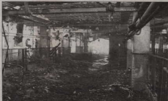
Wnętrze spalonej obory.
