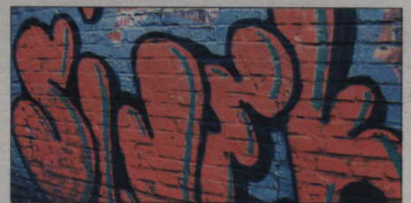
Dwaj młodzi ludzie malowali sprayem ściany budynków. Ich rodzice będą musieli zapłacić zniszczenie elewacji.
