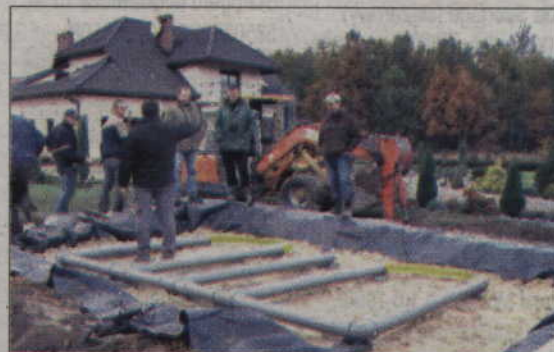
Właściciele tego domu postawili go na uboczu, blisko lasu. By żyć w zgodzie z naturą, zdecydowali się na własną oczyszczalnię ścieków.
