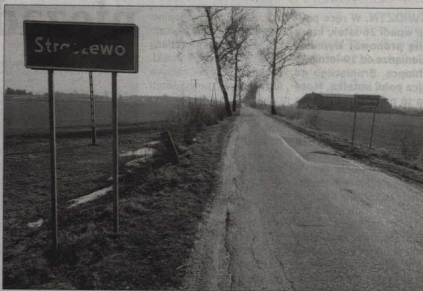
Obecnie trwa remont odcinka od Straszewa do skrzyżowania z drogą wojewódzką, biegnącą w kierunku Dubiela i Szadowa.
