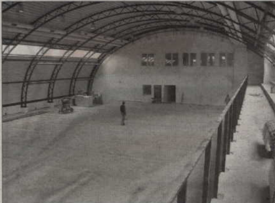
Powstaje hala sportowa przy II Liceum Ogólnokształcącym, najmłodszej szkole średniej w Kwidzynie.
