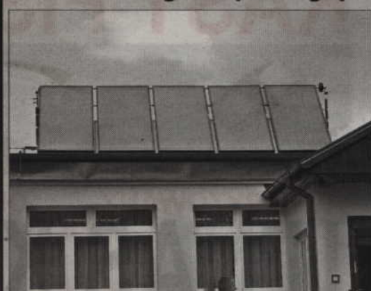
Kolektory słoneczne na dachu ośrodka zapewniają ciepłą wodę. Placówka ogrzewana jest całkowicie dzięki energii odnawialnej.
