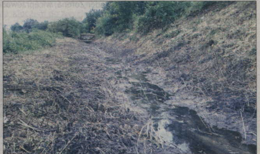
Tak wyglądał tuż po sierpniowej ulewie rów melioracyjny biegnący przy ul. Rodzinnej na osiedlu Zacisze.
