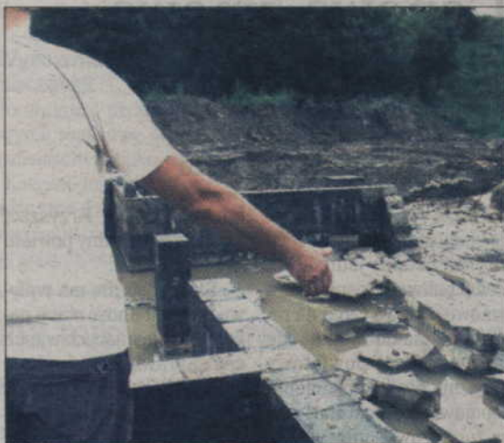
Podczas burzy najbardziej ucierpiała działka przy ul. Rodzinnej. Woda deszczowa zalała posesję i zniszczyła jedną ze ścian fundamentowych.
