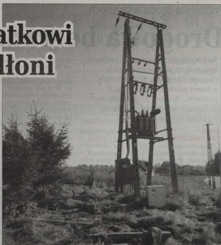
15-latek wspiął się na transformator i został porażony prądem.
