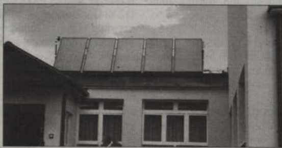
Instalacja solarna zamontowana została na zmodernizowanym budynku, w którym mieści się Specjalny Ośrodek Szkolno-Wychowawczy w Barcicach, w gminie Ryjewo. Fot. Jacek Kluczkowski
