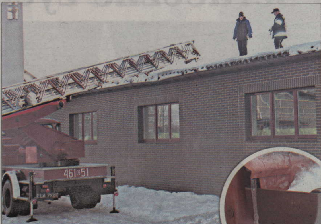
Zimą bardzo niebezpieczne są zwisające z dachów sople i zalegający śnieg.
