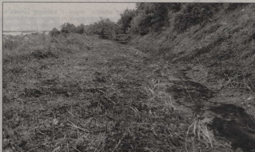
Niedrożne rowy melioracyjne to ogromne zagrożenie dla domów podczas większych ulew. Deszczówka dostaje się np. do piwnicy.
