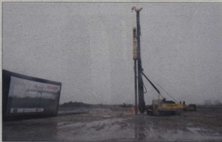
Budowa mostu rozpoczęła się jesienią ubiegłego roku. Most ma być oddany do użytku w grudniu 2012 roku.
