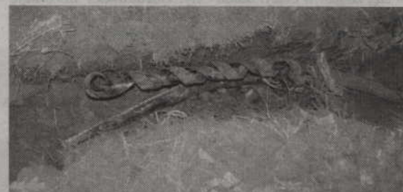
Skradziony kabel wart jest ok. 5 tys. zł.
